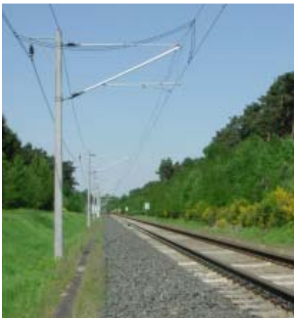
Versuchskabel im Siemens Testcenter Wildenrath
