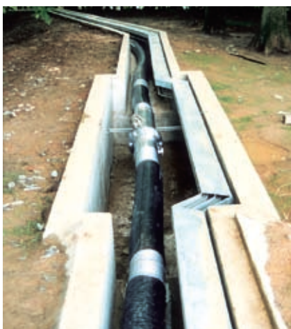
Lange Transferleitungen für LH2 Long Transfer Lines for LH2
